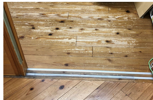
スギの床板の自然系木材保護塗装の一部剥離
