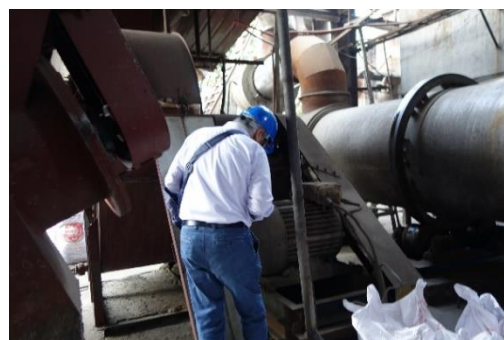
バイオマスボイラーの送風量の確認
